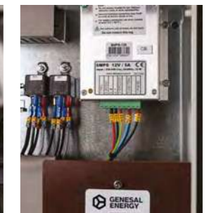
Mantenedor de nivel de batería de motor desde red externa
