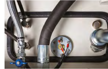
Depósito de combustible
